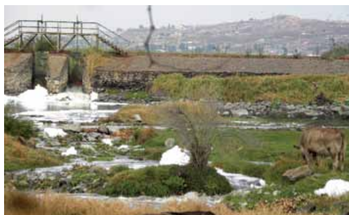
Cortina de la Presa El Ahogado, municipio de El Salto, Jalisco. Se observa la formación de espuma y la presencia de animales de granja.
